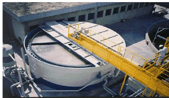
Tanque de separador por flotación
