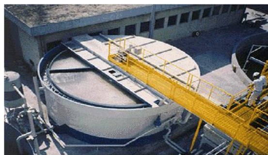
Tanque de separador por flotación
